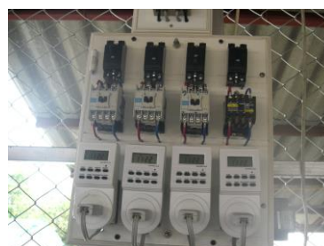
8. ระบบไฟฟ้า
